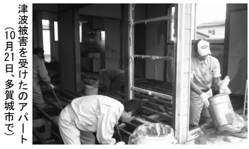
津波被害を受けたアパート(10月21日、多賀城市で)
